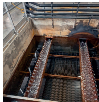
Injection de coagulants pour fixer les particules au fond du bassin.
